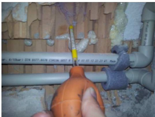
Obrázek 108 Nedotěsněné rozvody ve zděné stavbě.
