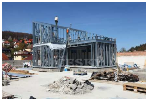
Obrázek 11 Ocelová konstrukce Lindab.[59]
