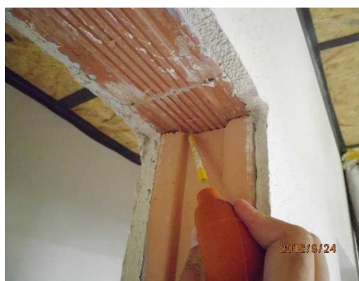
Obrázek 109 Neomítnutý otvor pro interiérové dveře.
