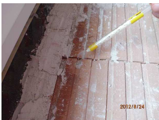
Obrázek 110 Infiltrace do neomítnutého zdiva.
