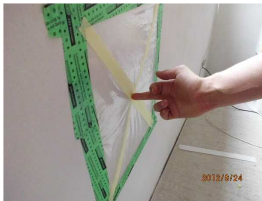
Obrázek 107 Vlasová trhlina v omítce s viditelnou infiltrací vzduchu.
