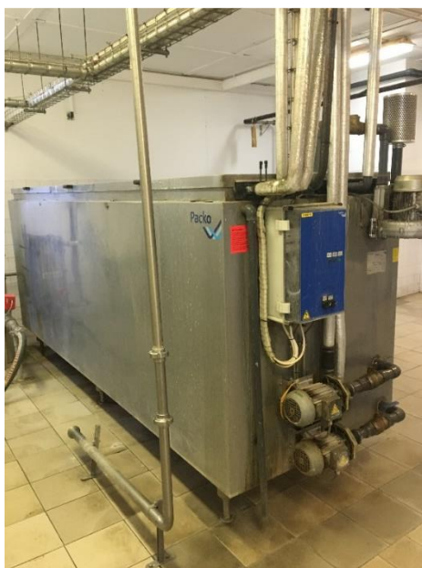
obr. 10 Nádrž na ledovou vodu na chlazení mléka
