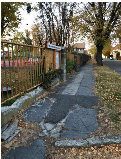
Obrázek 146: Špatný technický stav chodníku
