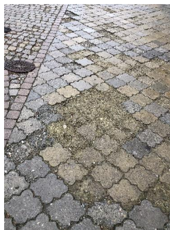
Obrázek 105: Špatný stav povrchu
