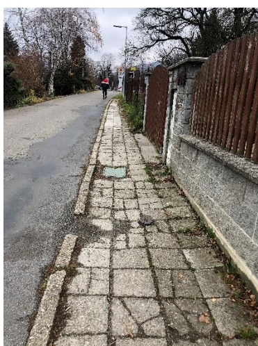
Obrázek 61: Špatný stav chodníku
