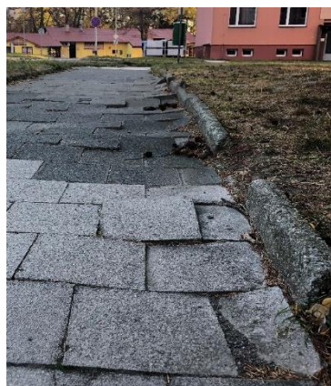
Obrázek 168: Špatný stav chodníku
