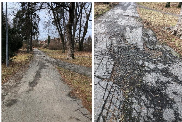
Obrázek 45: Špatný technický stav chodníku
