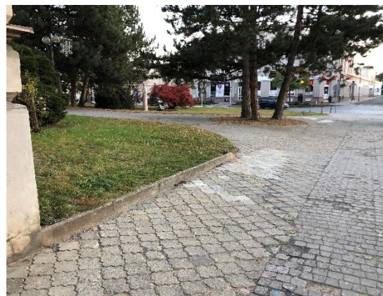
Obrázek 93: Špatný technický stav chodníku
