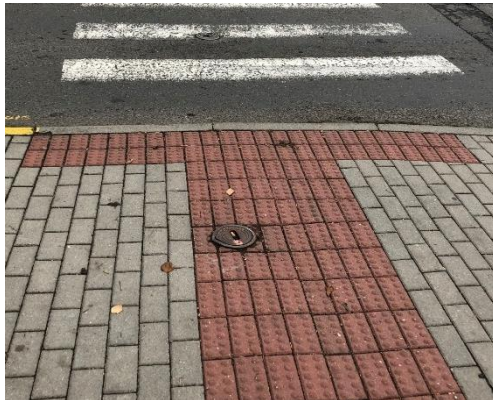
Obrázek 25: Varovný pás u přechodu pro chodce
