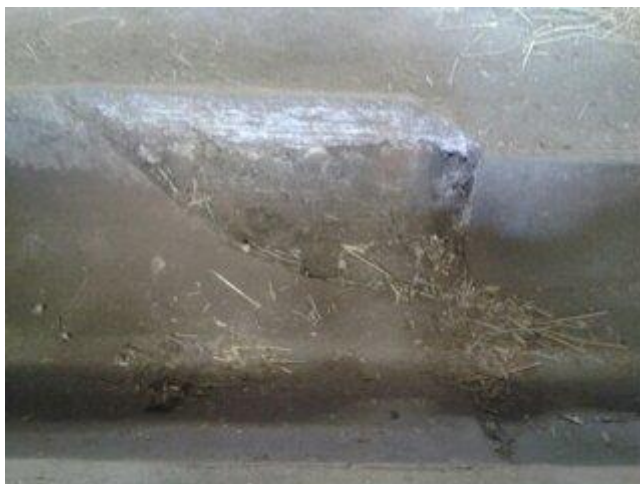
Obr. 2 Rozbitý žlab je pro zvířata nebezpečný (Klečánková, 2014)
