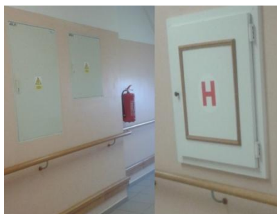
Hydrant a jističe el. Energie
