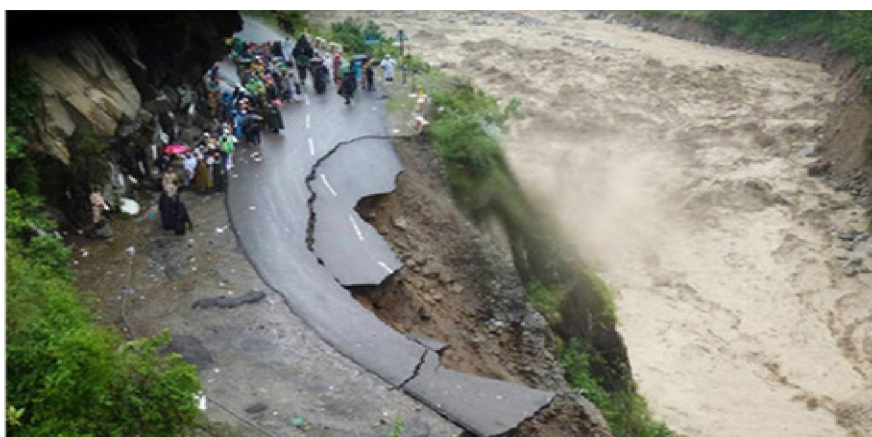
Obr. č. 11. Po povodních často následují sesuvy půd. Na obrázku je poničená silnice důsledkem sesuvu v severním indickém státě Uttarakhand. (Zdroj : https://www.commondreams.org/news/2013/06/21/5000-missing-india-floods-scientists-say-global-warming-blame )
