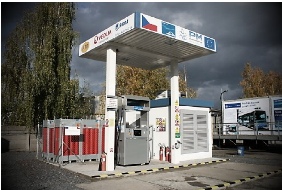
obr. 10 - Čerpací stanice na vodík v Neratovicích [30]
