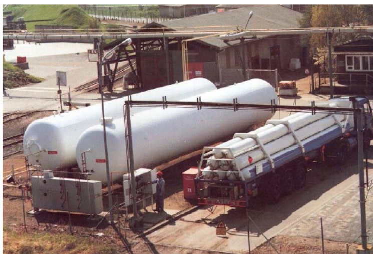
obr. 11 - velkokapacitní zásobník s vozem určeným pro přepravu stlačeného vodíku [19]
