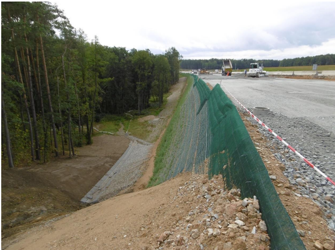
Obrázek 32: Armovaný svah (EUROVIA CS, srpen 2018)
