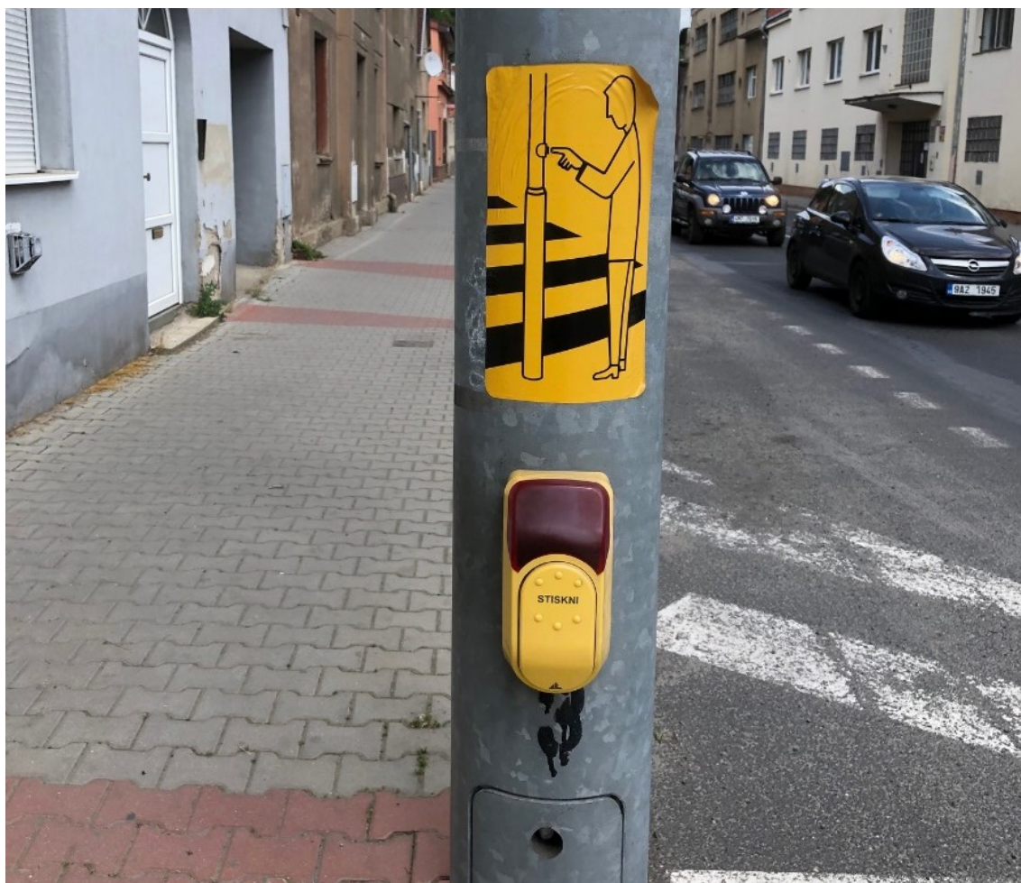
Obr. 3.1 Tlačítko chodci v provoz uváděného semaforu
