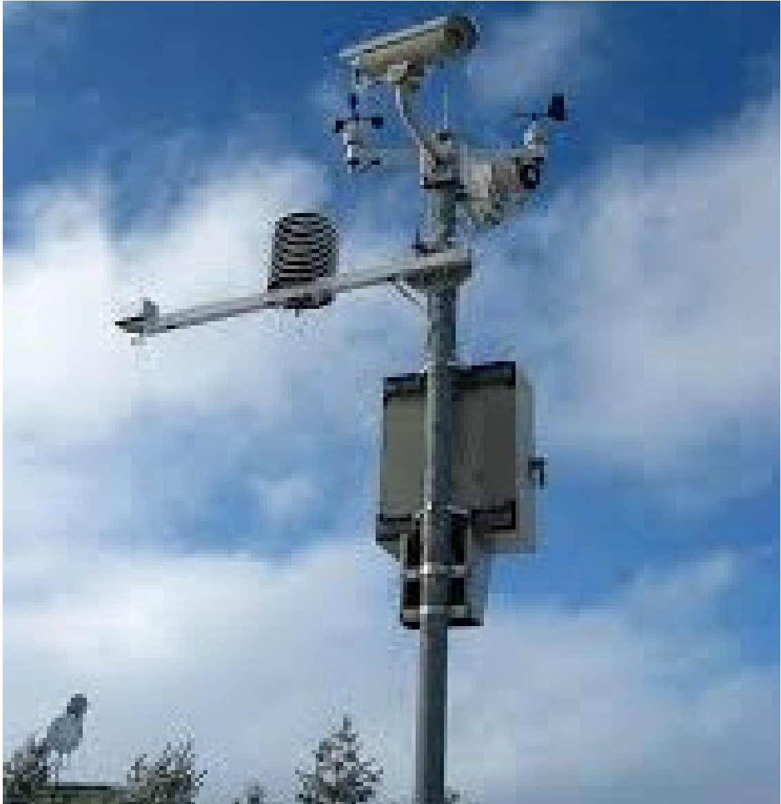
Obr. 2.14 Silniční meteorologická stanice
