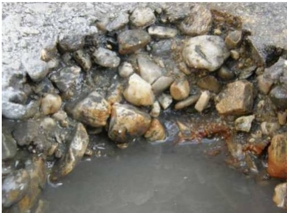
Obr. 7 Jímka v elektrárně narušena odpadní vodou
