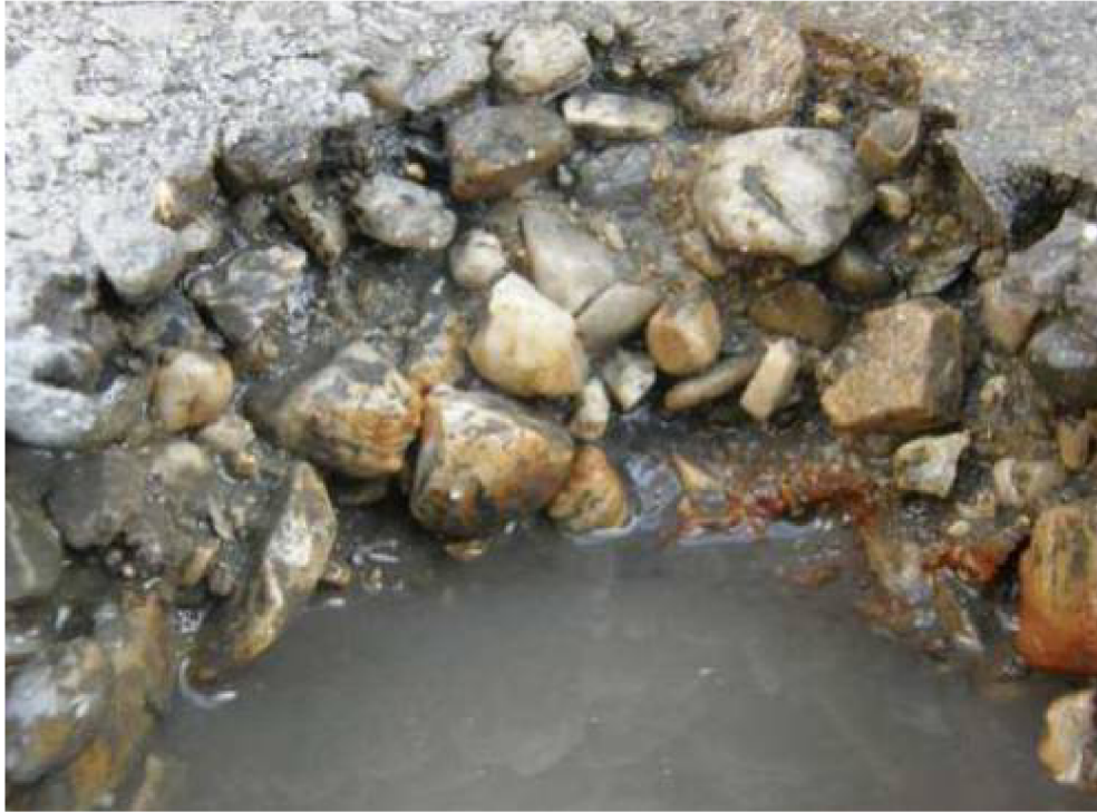
Obr. 7 Jímka v elektrárně narušena odpadní vodou
