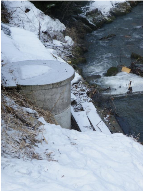
Příloha 4 : Fotografie: Zařízení pro odběr vody.
