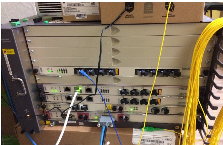
Obr. 3.4: OLT Huawei MA5683t ve zkušebním zapojení.
