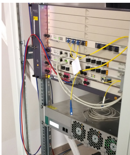
Obr. 7.3: Umístění OLT Huawei MA5683t a napájecího zdroje IMCO Power LS1500 v racku.
