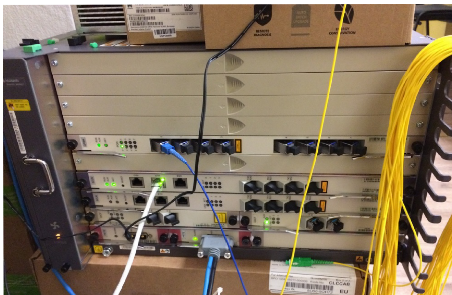
Obr. 3.4: OLT Huawei MA5683t ve zkušebním zapojení.
