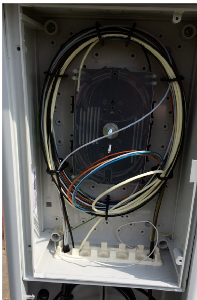
Obr. 7.6: Kazeta se sváry uvnitř pilířového rozvaděče na VTU.
