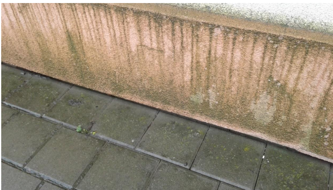
Příloha 2: vzorek č. 2 – fasáda budovy vlakového nádraží
