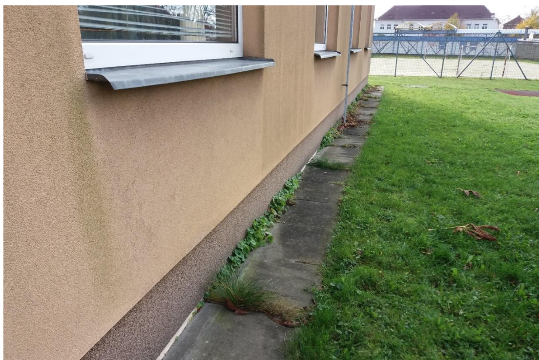
Příloha 16: vzorek č. 16 – omítka – jídelna gymnázia (v místě odtékající vody z parapetu)
