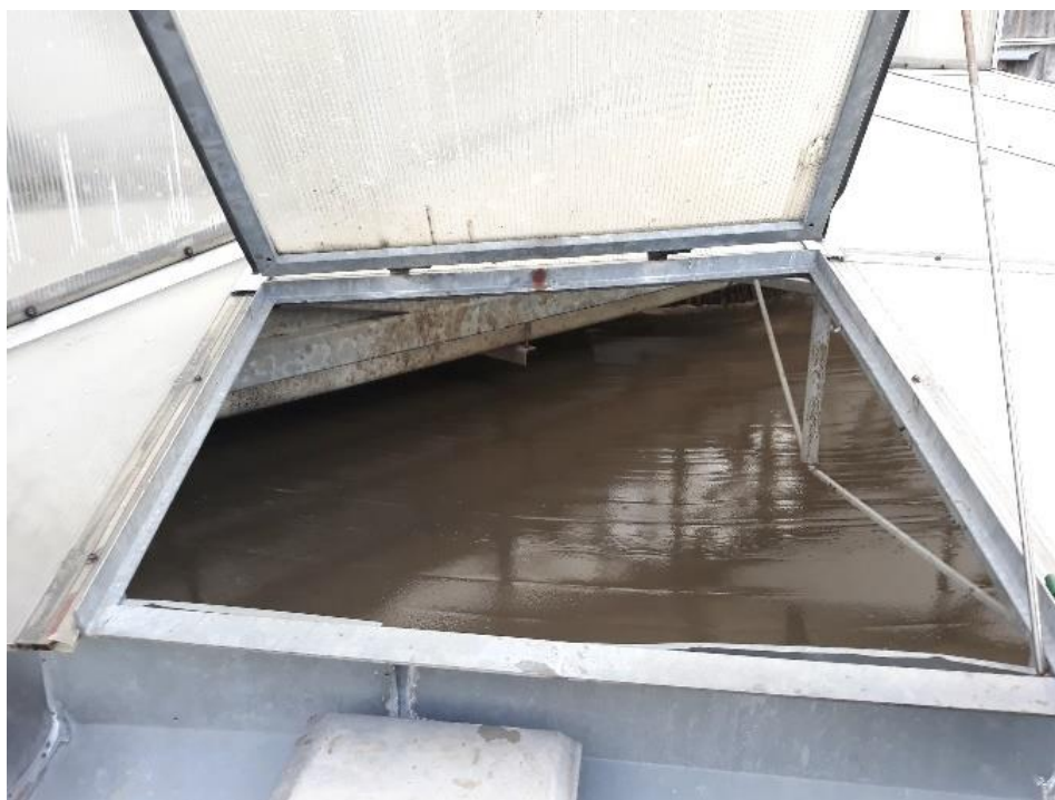
Obrázek 22: Flotační nádrž sloužící k částečnému zahuštění přebytečného kalu
