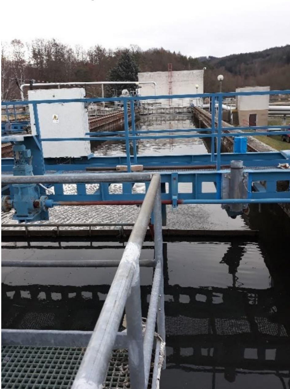
Obrázek 17: Poslední stupeň mechanického čištění - usazovací nádrže
