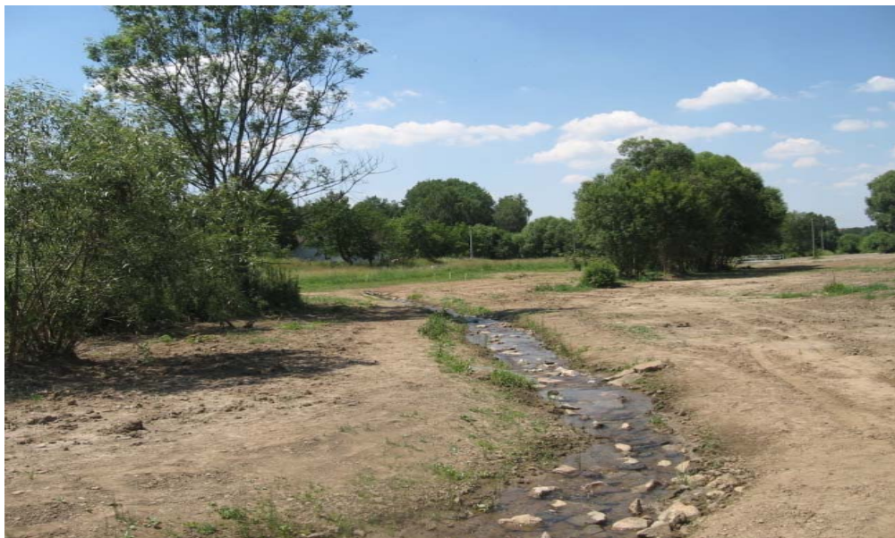
obr. č. 23 Revitalizace Hrobského potoka v k.ú. Kozmice, koryto po ukončení revitalizace, bez zapojení okolního porostu
