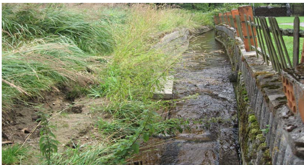
obr. č. 11 Destrukce opevněného koryta v obci Kunžak na vodním toku „Struha“
