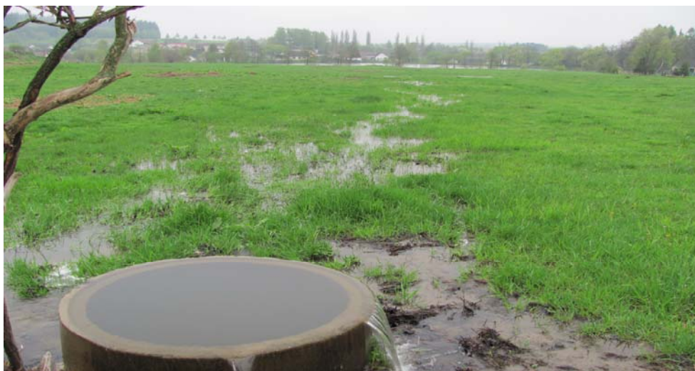
obr. č. 7 Nefunkční a poškozené odvodnění v k.ú. Bohdalín, jaro 2010
