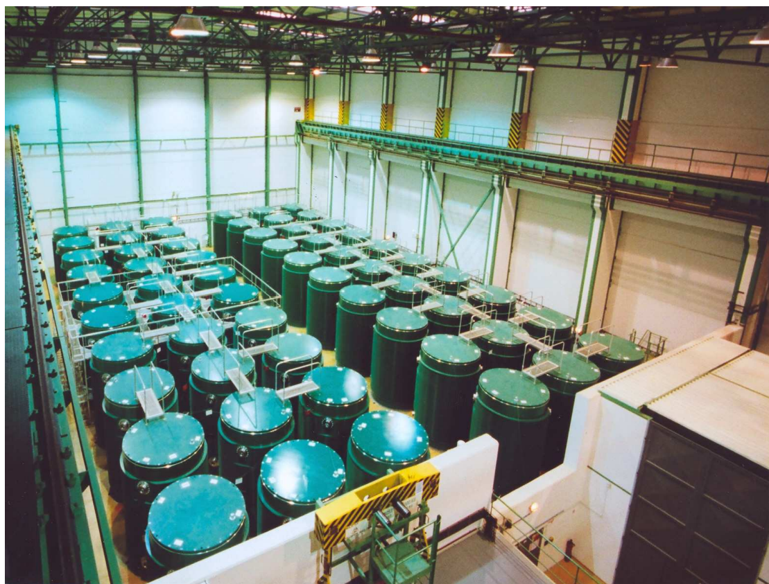
Obr. 3.6 Kontejnery Castor v meziskladu JE Dukovany
