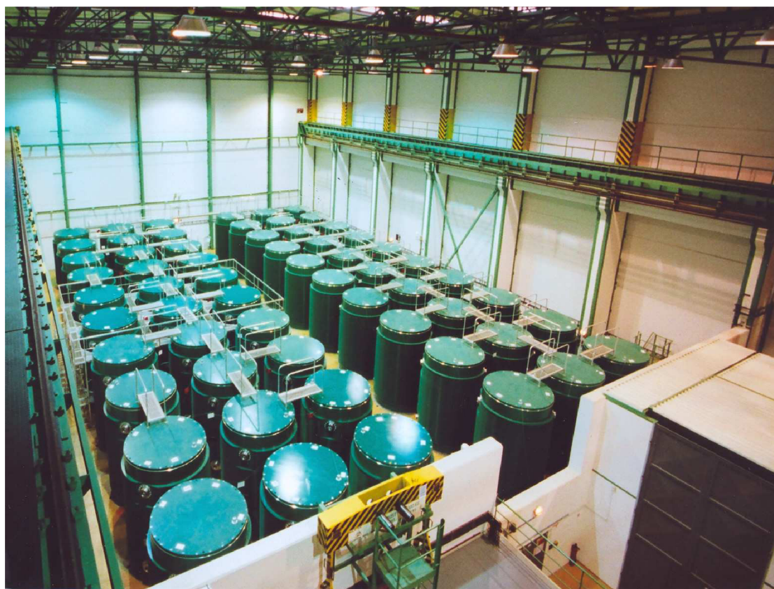
Obr. 3.6 Kontejnery Castor v meziskladu JE Dukovany
