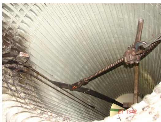
Obr. č. 26 Vytažení poškozené tyče
