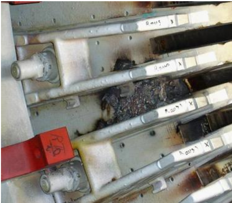
Obr. č.30 Místo poruchy
