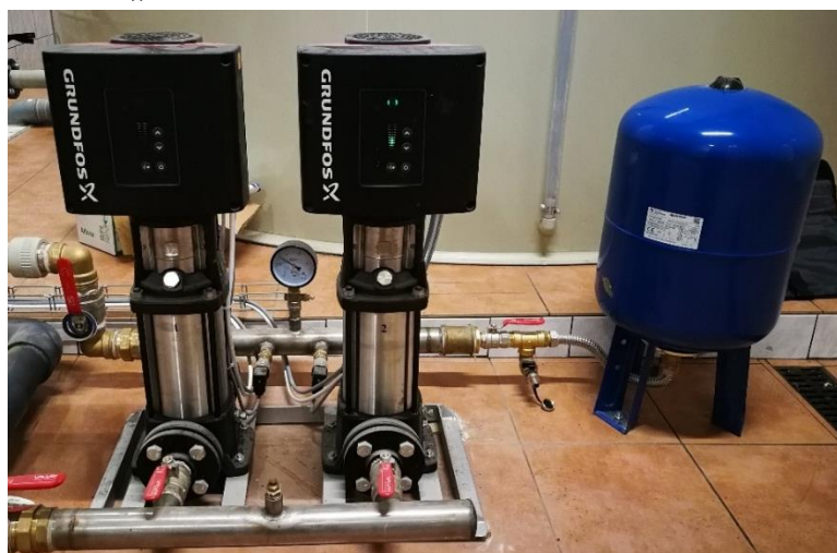
Obrázek 39 – Automatická tlaková stanice (ATS)
