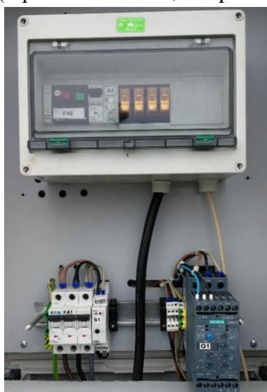
Obrázek 25 – Ovládací sloupek pro čerpadlo ve studni
