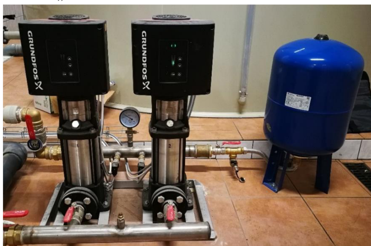
Obrázek 39 – Automatická tlaková stanice (ATS)
