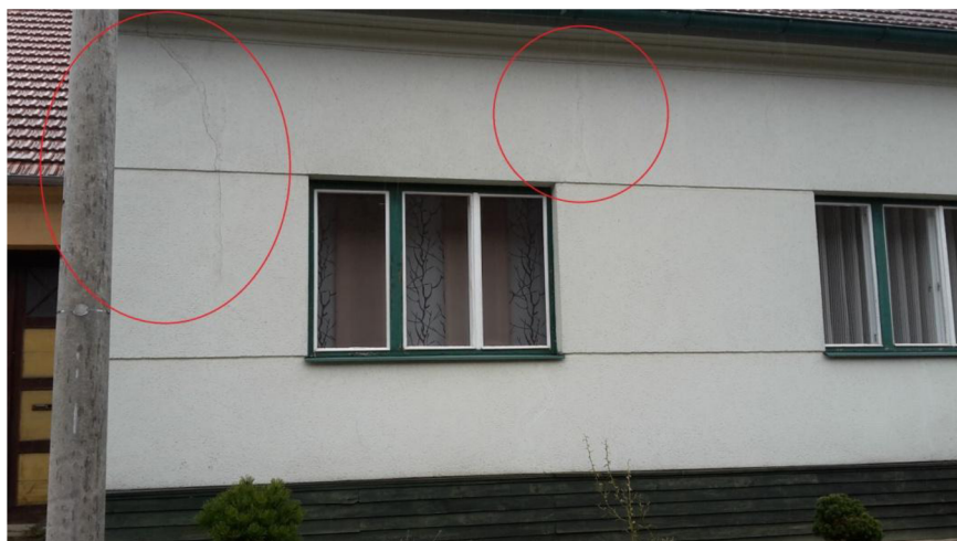
Obrázok č. 8 Poškodená budova na ulici Sušilova s vyznačenými prasklinami (autor)
