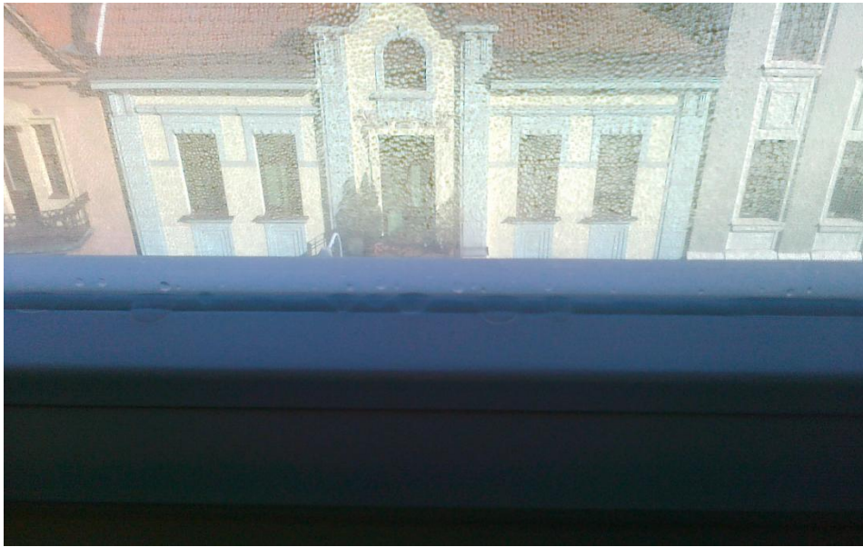
Obr.D.2.2 Kondenzace vody na skleněné výplni okna
