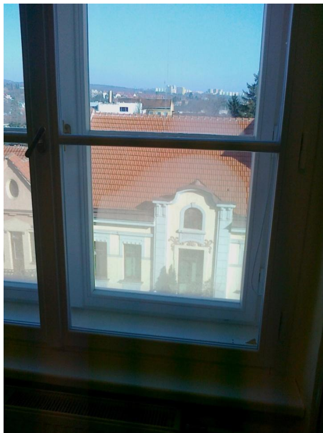
Obr.D.2.1 Kondenzace vody na skleněné výplni okna
