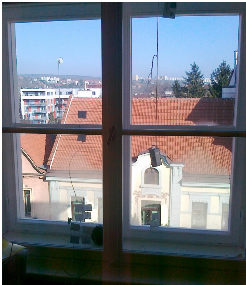
Obr.D.2.3 Kondenzace vody na skleněné výplni okna
