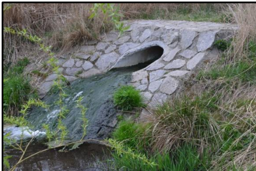
Obr. 23 – Výpust z ČOV, úsek Svej_3, vlastní foto.
