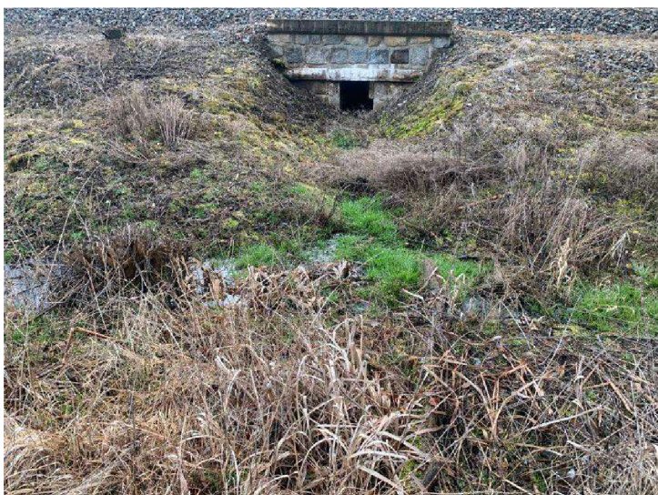
Obr. 12: Výustní objekt přečištěné odpadní vody
