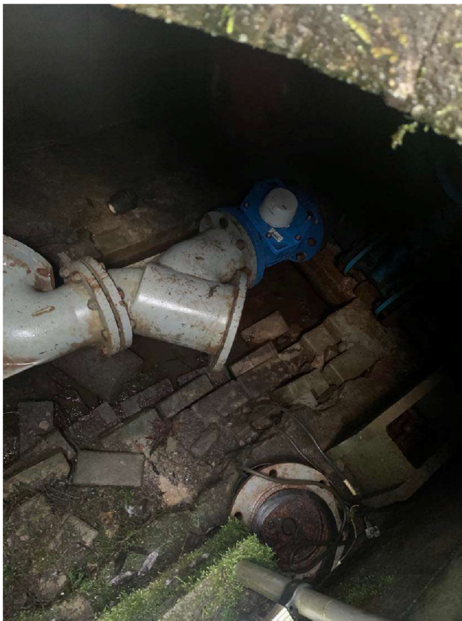
Obr. 10: Cejchované měřidlo vody u čerpadel pro závlahu
