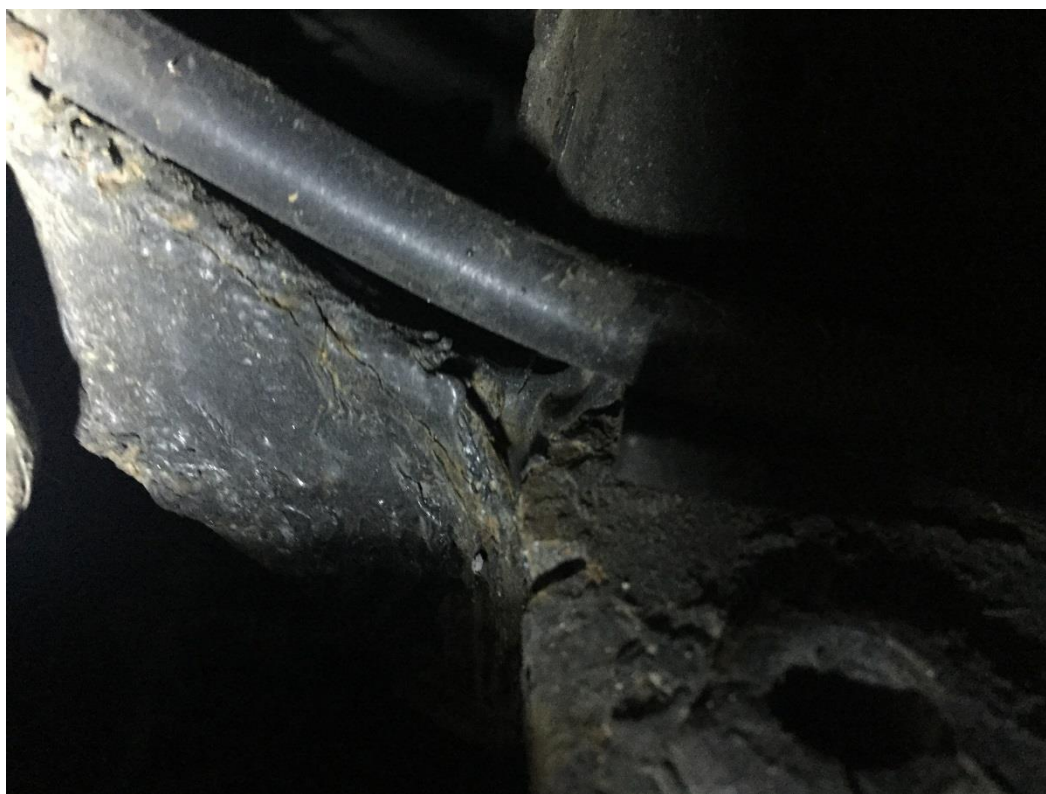
Obrázek 12 - Vážná koroze pomocného rámu zdroj (19)
