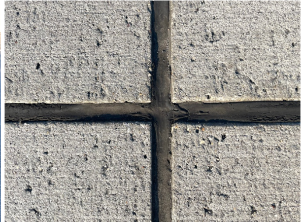
Obrázek 22: Detail řezané spáry vyplněné pružnou zálivkou.
