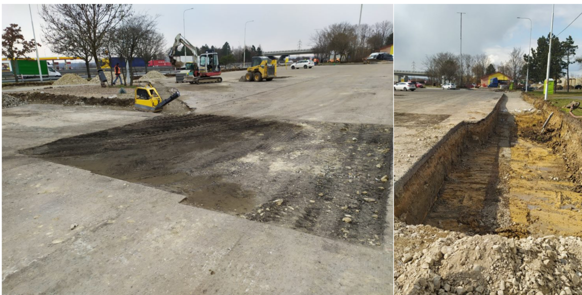
Obrázek 19: Rekonstrukce dálniční odpočívky Ladná. Vlevo – odfrézovaný povrch rekonstruovaného parkoviště. Vpravo – přechod mezi vyfrézovanou částí parkoviště pro kamiony a částí s odstraněnou skladbou vozovky, určenou pro osobní automobily [22].
