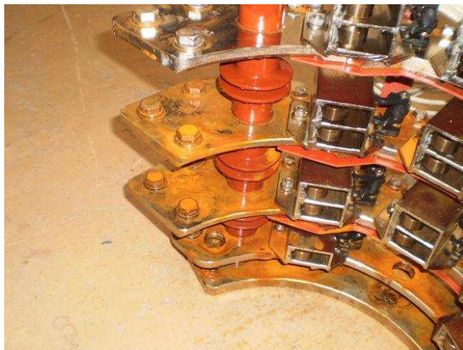
Obr. 4.15: Znáznornění stavu původního sběracího ústojí po ukončení korozní zkoušky – pohled zespodu [18]
