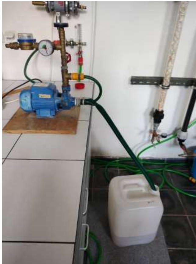
Obr. 27 Čerpadlo a barel s modelovou vodou [17]
