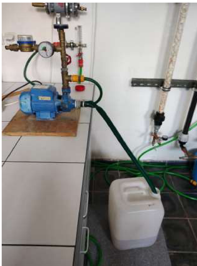
Obr. 27 Čerpadlo a barel s modelovou vodou [17]
