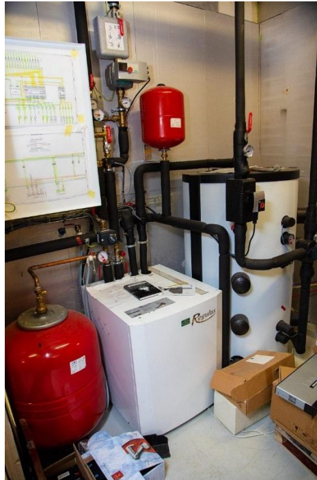
Obr. 4.2 Technické zázemí v datacentru pro ohřev a uchování teplé vody [25].
