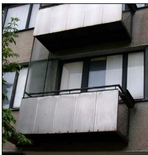
Obr. č. 43 – Původní závěsné balkóny z roku 1962-1970, foto z ulice Brožíkova (červenec 2009)
