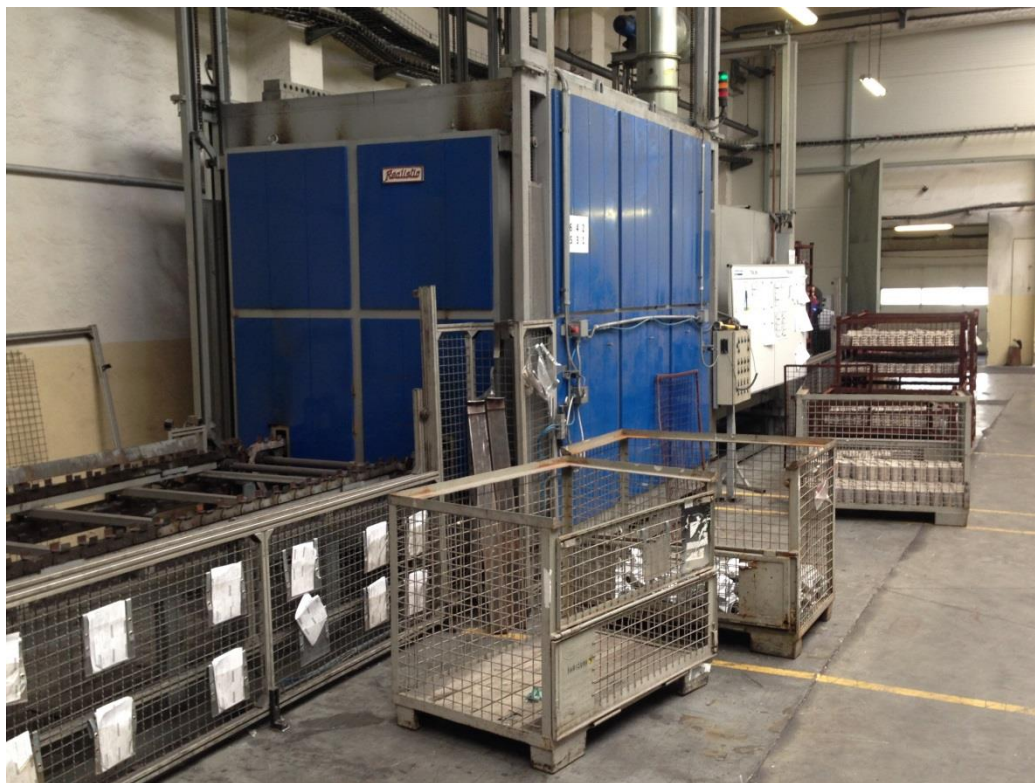
Obr. 27 – Žíhací pec pro tepelné zpracování režimu T5 ve firmě MOTOR JIKOV Slévárna a.s.
